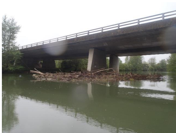
Embâcle au pont de Guignicourt (Embâcles 135)
