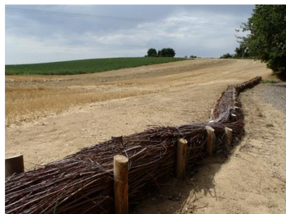
Maîtrise du ruissellement et de l'érosion
