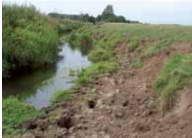
Avant travaux : berge déstabilisée
