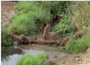
Avant travaux : embacle créé par une clôture
