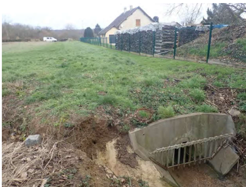
Figure 44: Portion de cours d'eau busé à Soizy aux Bois
