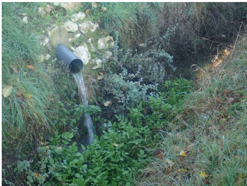
Figure 51: Rejet d'eau usée au niveau de Fontaine Armée
