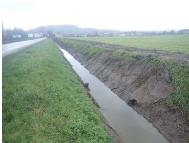
Figure 21 : Curage reprofilage et recalibrage dommageable sur le Bonon aval
